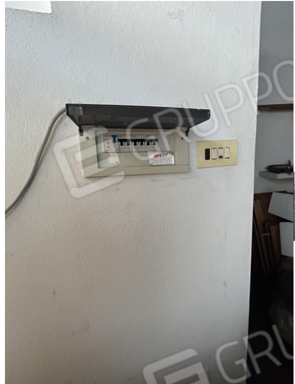
Foto 16 Vista particolare quadro impianto elettrico
