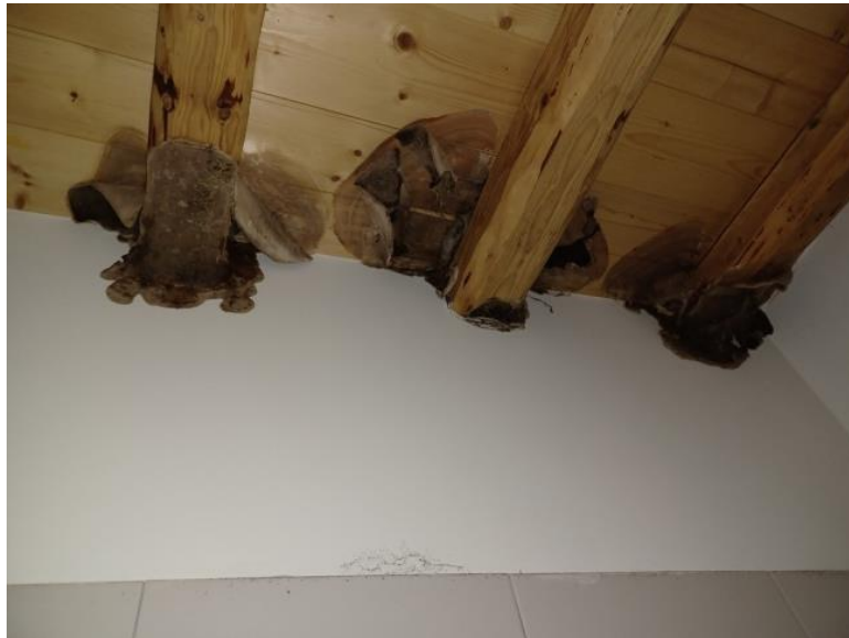
fughi in corrispondenza del solaio
