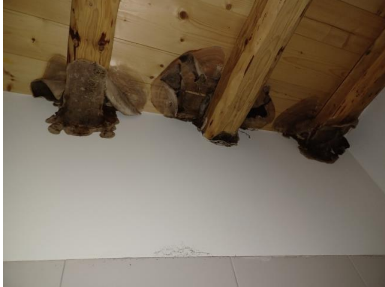
sub 9 - infiltrazioni d'acqua
