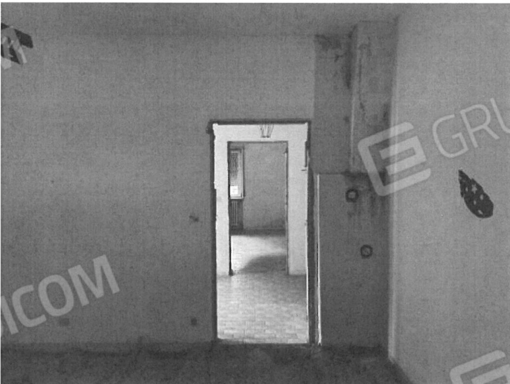
Foto 28: PT (sub. 3) camera angolo Sud
