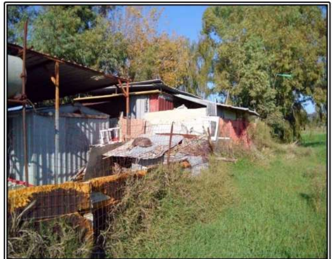
Figura 59 lamiere e materiali di risulta sul retro delle baracche
