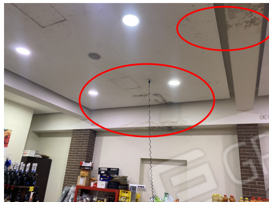
Foto 11: Magazzino 1_Particolare infiltrazioni
