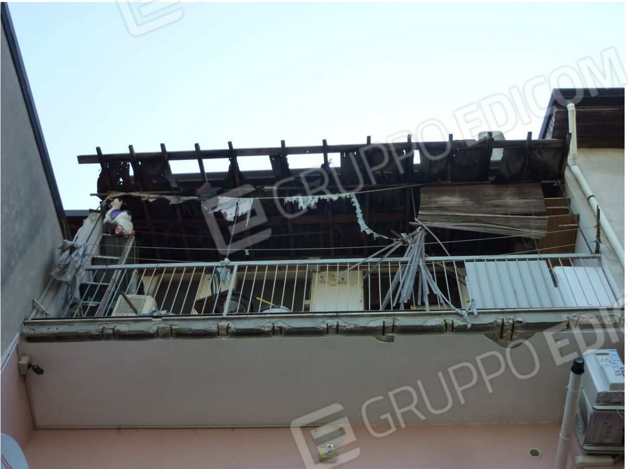
6. Particolari delle lesioni del secondo balcone e della gronda sul fronte del cortile interno
