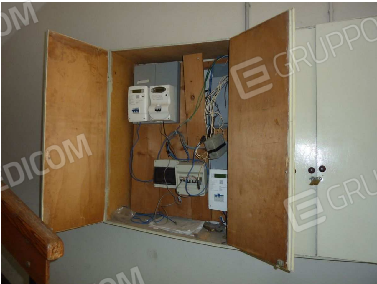
27. Contatore Enel in armadietto al piano terra del vano scala condominiale
