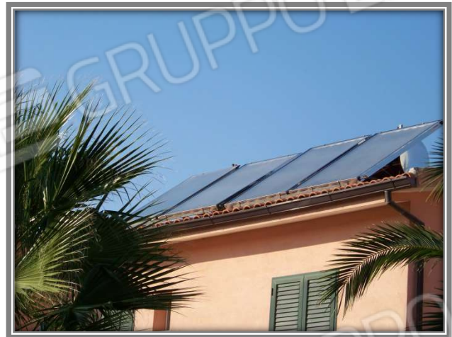
Foto 17 – Pannelli con Serbatoi per l'accumulo di Acqua Calda
