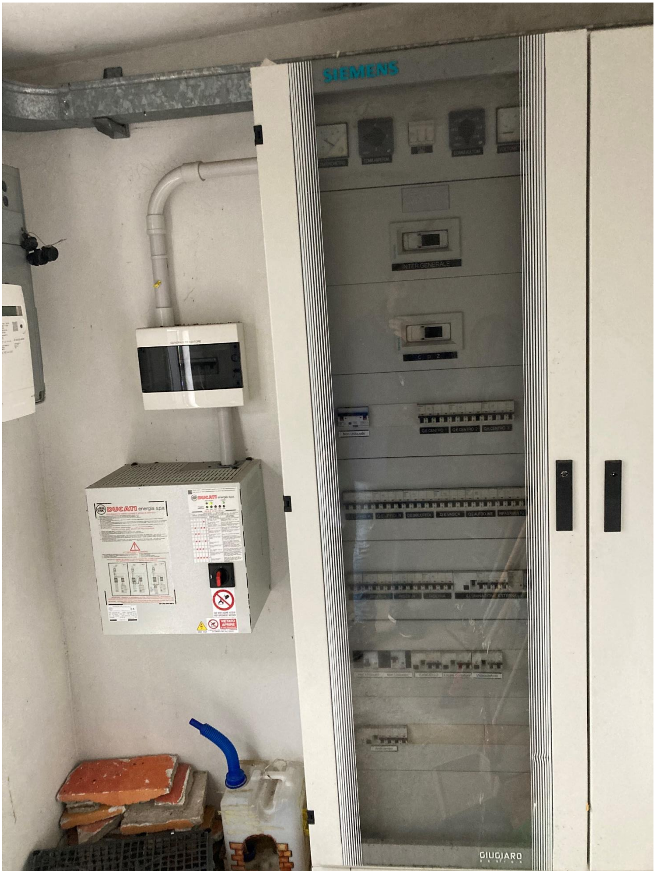
Interno cabina elettrica
