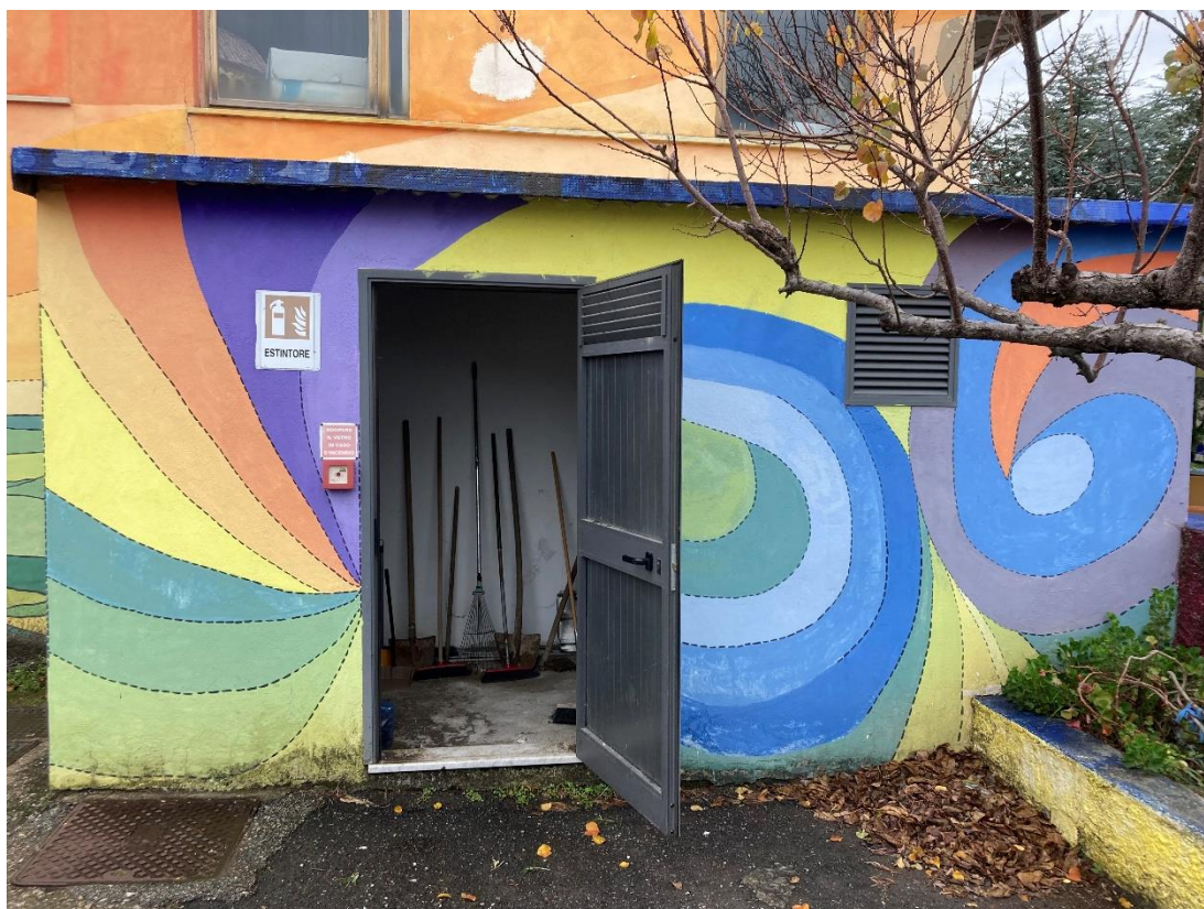
Locale cabina elettrica
