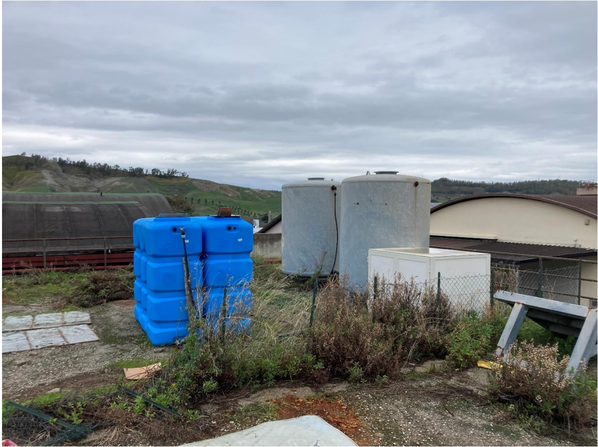
Accumulo antincendio ed idrico sanitario
