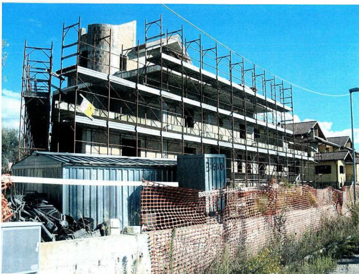
Foto 31 – Cespite n°7: veduta del fabbricato in costruzione in Località Collina Salerno (facciata ovest vista di scorcio)
