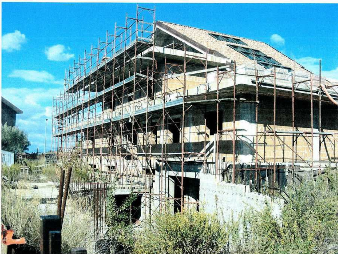
Foto 33 – Cespite n°7: veduta del fabbricato in costruzione in Località Collina Salerni (facciata ovest vista di scorcio)
